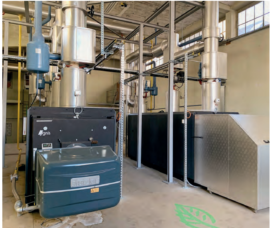
■ Einer der beiden Kessel mit Dreizler-Brenner.
