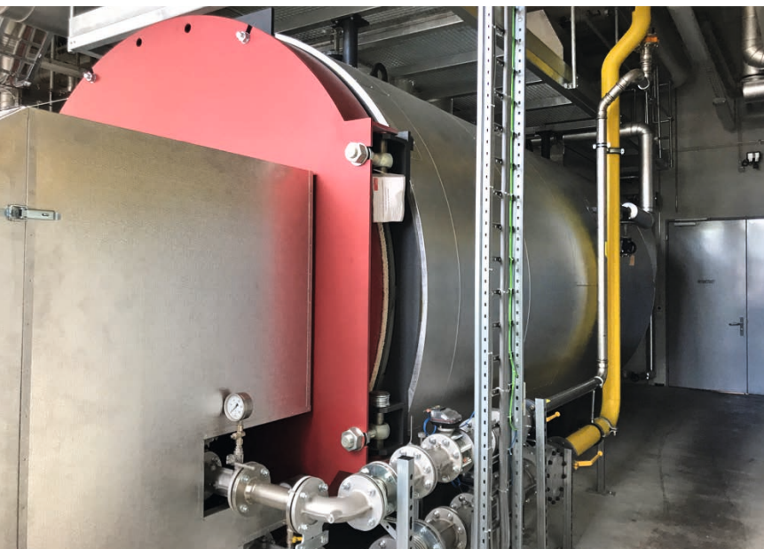
Astebo-Kessel mit Zuleitung der beiden Gase (Erdgas, Biogas) zum Brenner.
