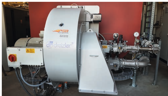
Der Dampfkessel mit dem Dreizler-Zweigasbrenner ohne Haube.
